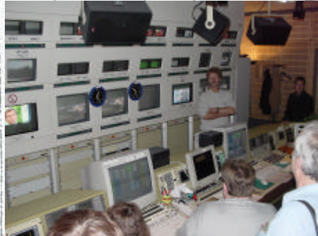
Hauptschaltraum im 4. Untergeschoss des ZDF-Studios Zollernhof
